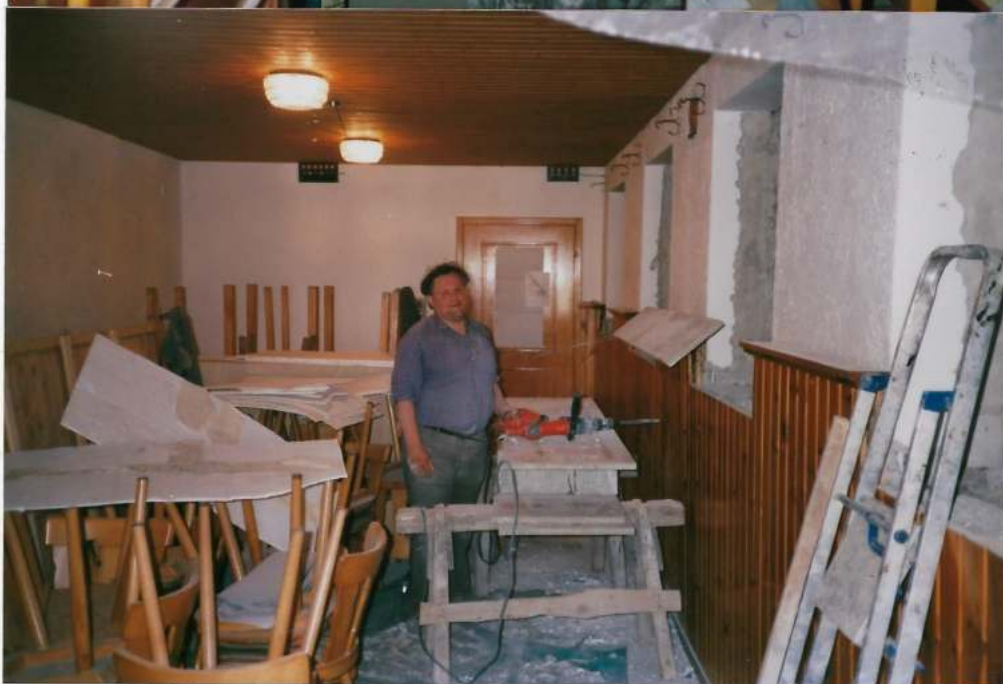
geht's noch fürchterlich zu... noch müssen Brecharbeiten für die Lüftung gemacht werden
